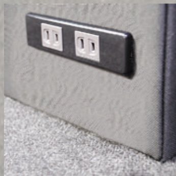
室内コンセント
