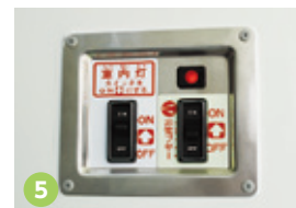
5 非常警報装置
